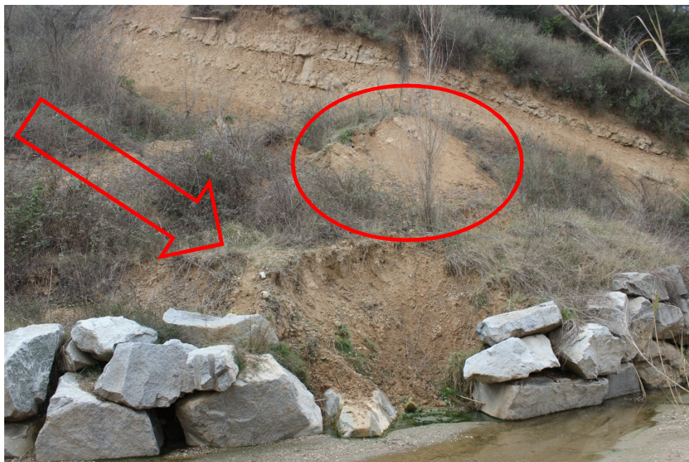
Fotografia 4. Escullera a la base de l'escarpament en roca tova a la subàrea C. S'observa una massa de roca tova caiguda del vesant (cercle) i la deformació de l'escullera pel moviment del terreny (fletxa).
