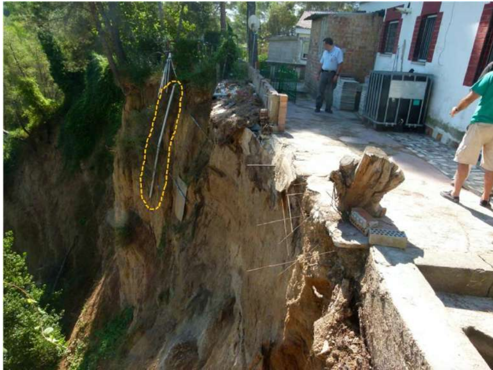
Fotografia 9: Vista de la cicatriu del desprendiment des de la part superior del talús. S'observa l'afectació a la part posterior de la parcel·la on ha desaparegut part del murat posterior. A l'esquerra de la imatge s'observa un tub que desaigua directament al talús. Font: AP-0058/13 (IGC, 2013).
