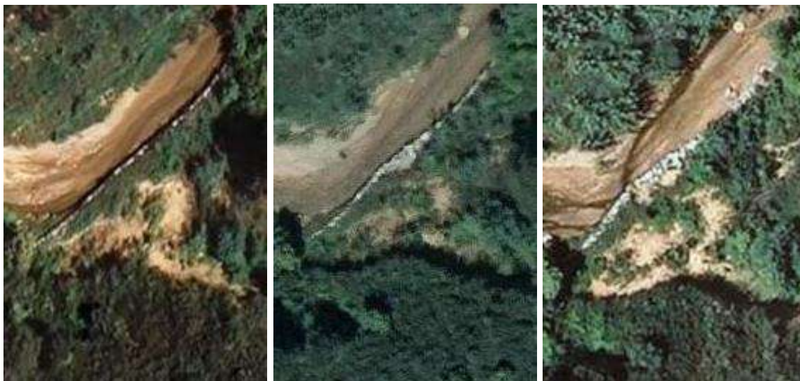
Fotografia 5: Ortoimatges dels anys 2010, 2011 i 2012, on s'observa la progressiva deformació de l'escullera de l'àrea C.
