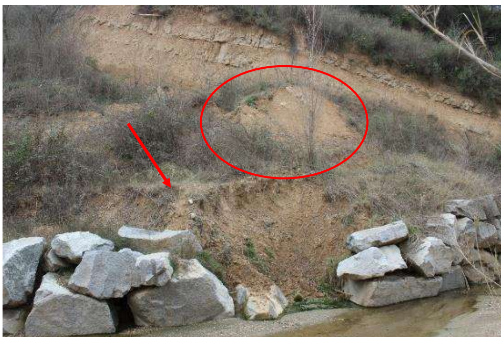
Fotografia 4: Escullera a la base de l'escarpament en roca tova a l'àrea C. S'observa una massa de roca tova caiguda del vesant (cercle) i la deformació de l'escullera pel moviment del terreny (fletxa).
