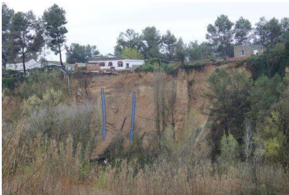
Fotografia 8: Escarpament en roca tova al torrent de Can Valls a l'àrea L (plànol 4). L'any 2013 va patir dos desprendiments que amenaçaren un dels habitatges.
