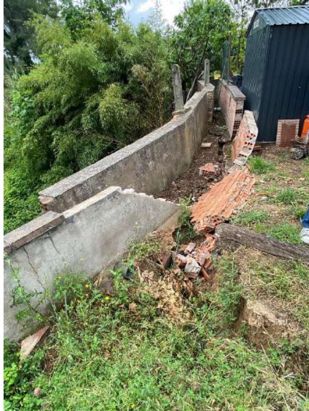
Fotografia 11: Tanca posterior de la parcel·la 19 del l'avinguda de la Pineda, on s'observen les afectacions pel despreniment d'abril de 2020.
