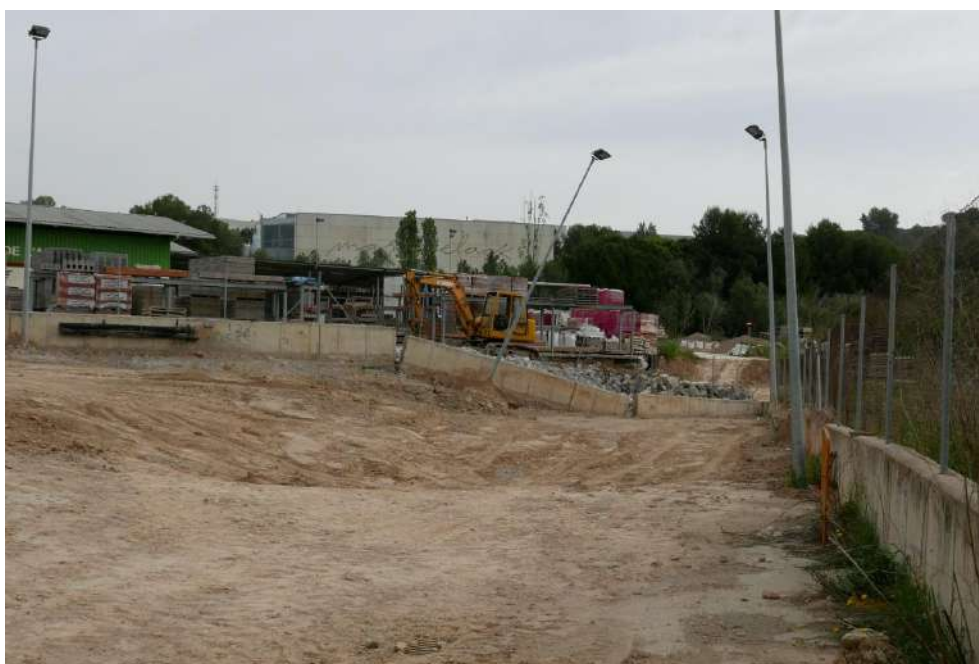
Fotografia 7: Vista de l'esquerda amb afectació a les parcel·la 20 i el mur amb la parcel·la 19 amb un salt d'aproximadament 0,5 m. Font: AP-0042/18 (ICGC, 2018a).
