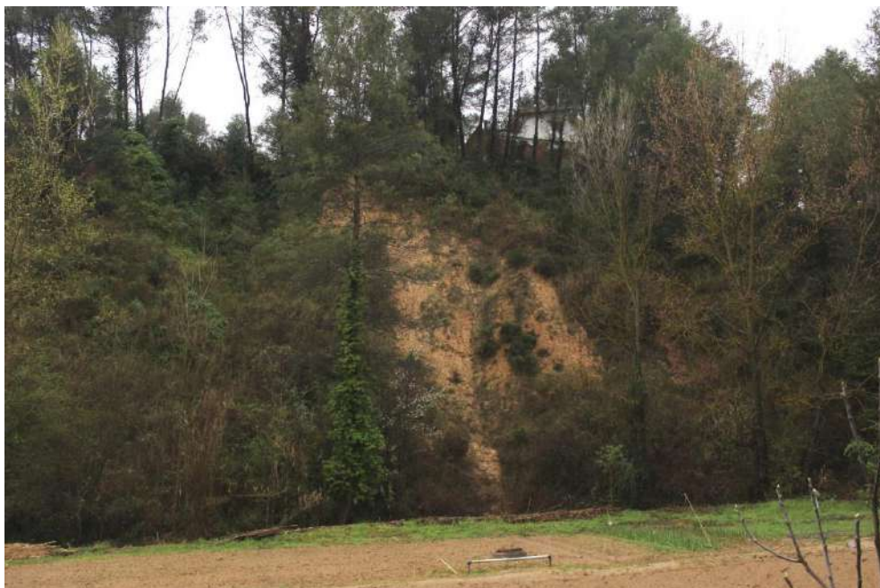
Fotografia 10: Desprendiment recent al torrent de Can Bonastre (o de la Font Santa), àrea L (plànol 4).
