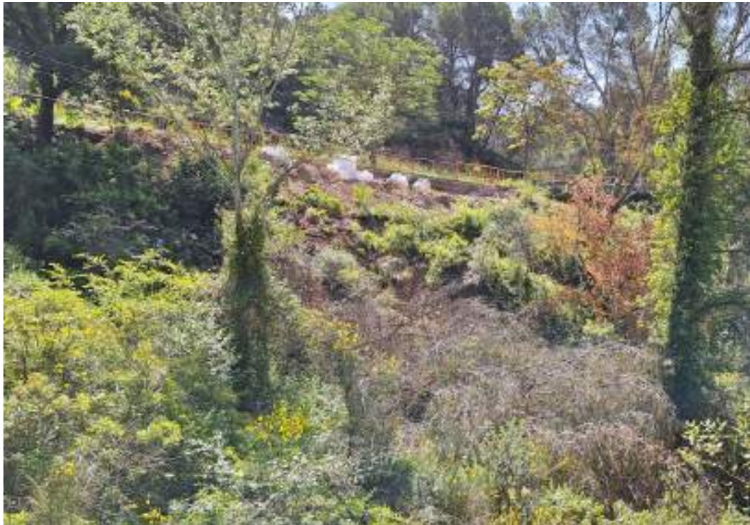
Figura 6. Imatge de l'esllavissada amb els primers treballs de contenció duts a terme. Imatge presa al juliol de 2024.
