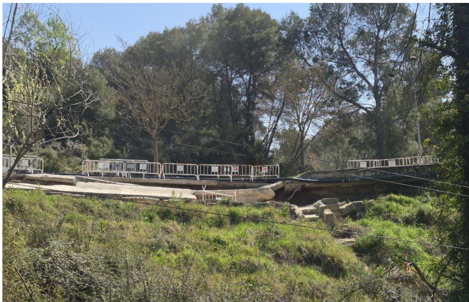
Imagen 13. Estado actual del estribo noroeste con progresión clara de la inestabilidad a 23/03/2026
