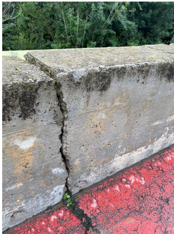
Imagen 9. Vista de pretil y losa fracturado.
