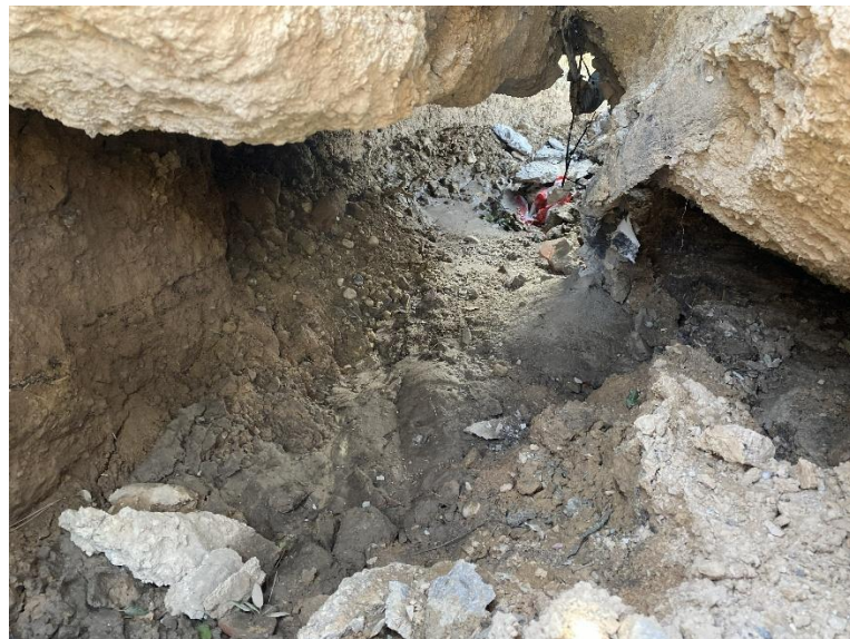
Imagen 15. Vista de la socavación bajo la losa causada por la escorrentía incontrolada.
