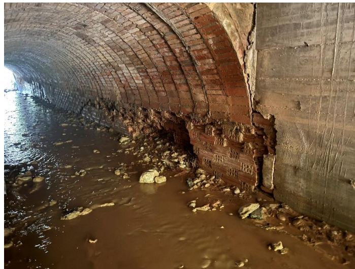
Imagen 8. Perdida de apoyo del hastial por socavación en el interior de la obra de drenaje.
