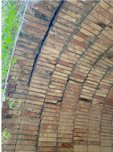
Imagen 5. Estado previo al derrumbe de la sección de emboquille de la galería de drenaje.
