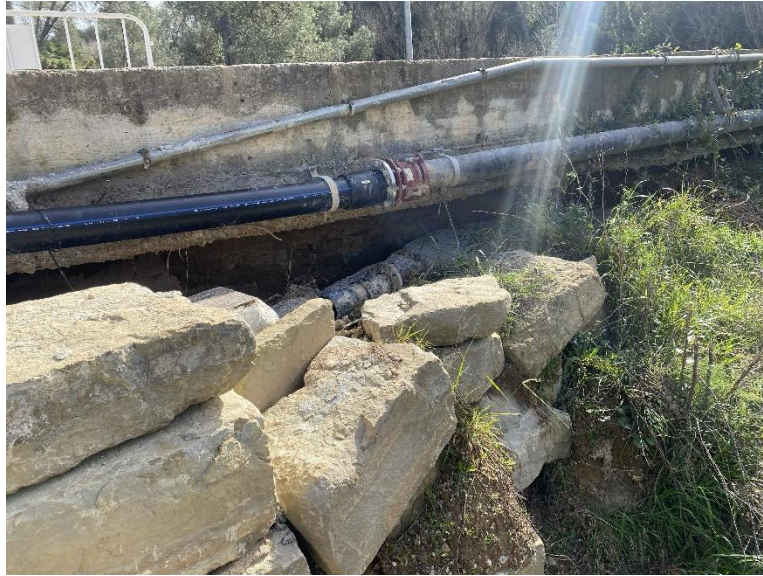
Imagen 14. Descalce de la losa y el pretil de la calzada en el estribo noroeste.
