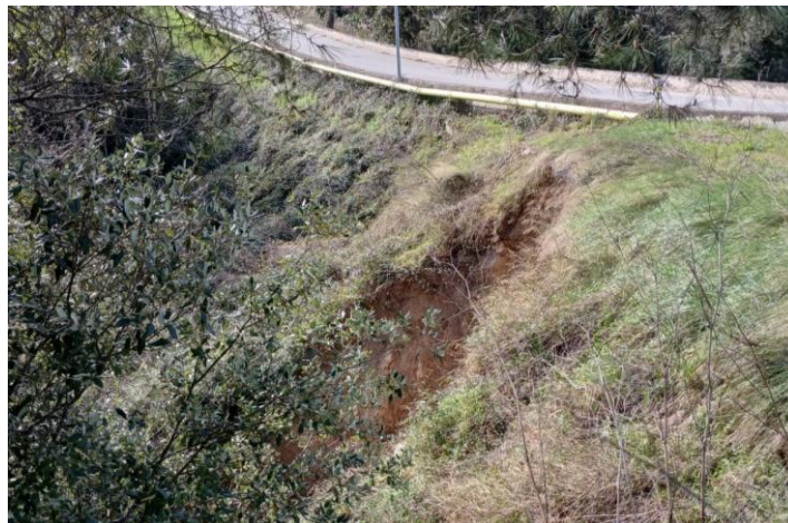
Imagen 1. Vista de una rotura en el lateral este del terraplén.
