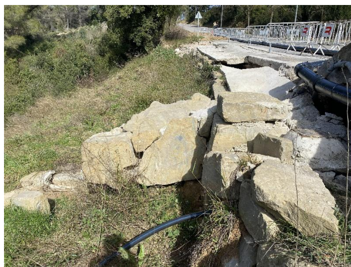
Imagen 11. Deslizamiento y rotura de la reparación en el estribo de lateral noroeste
