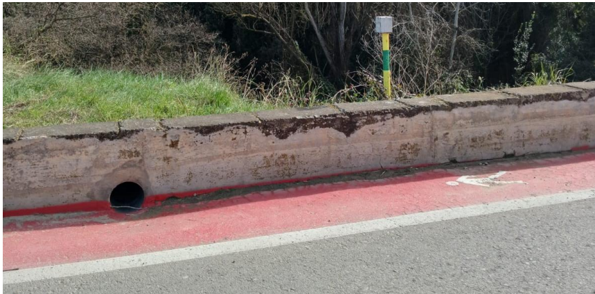
Imagen 10. Perforación lateral en el pretel para evacuación de agua acumulada.
