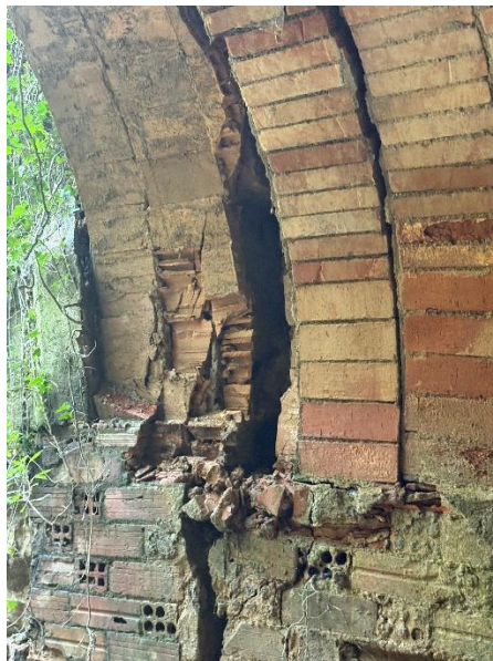
Imagen 6. Estado actual de ruina del emboquille aguas arriba.
