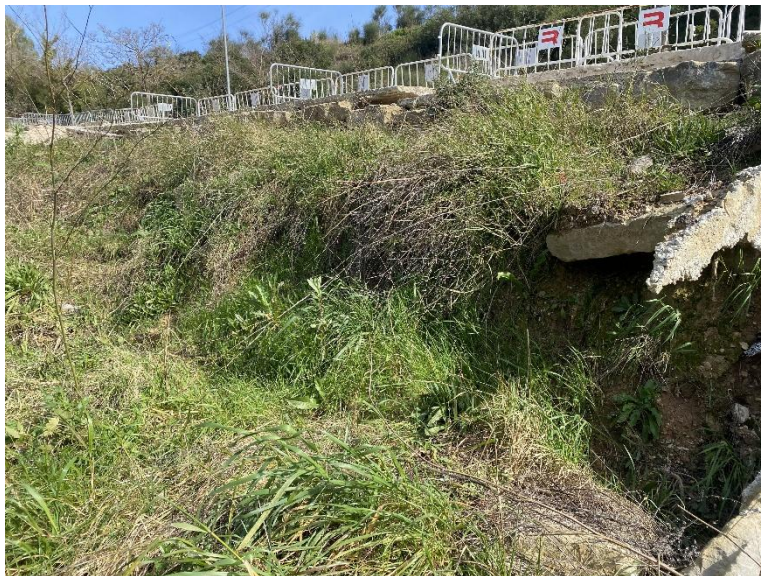
Imagen 12. Vista de uno de los escarpes de deslizamiento en el estribo noroeste del terraplén.
