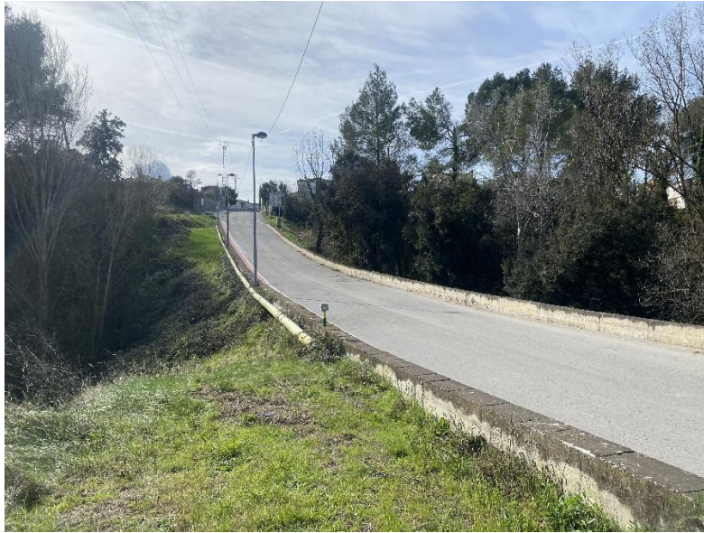
Imagen 3. Vista de la coronación del talud este mirando hacia el sur. En la parte media se observa la irregularidad de la superficie del talud y la elevada pendiente del escarpe correspondiente a los deslizamientos previos.
