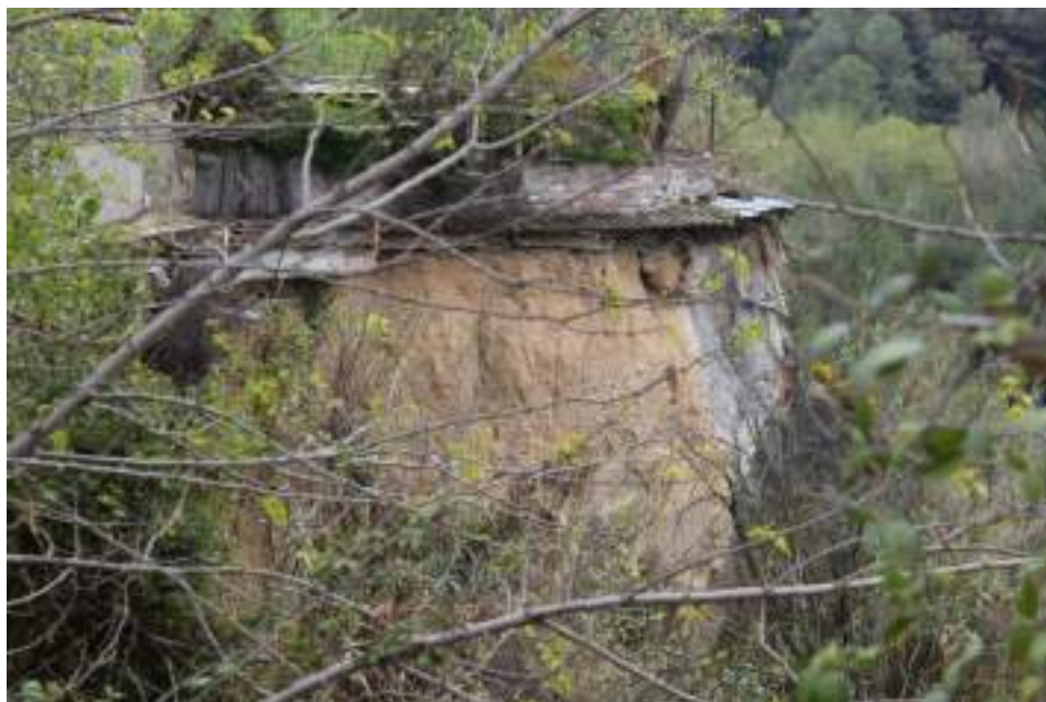
Fotografia 10. Escarpament amb petites i freqüents esllavissades al front al torrent del Salt de Can Llopart, entre els carrers de Tarragona i de Lleida (plànol 5).
