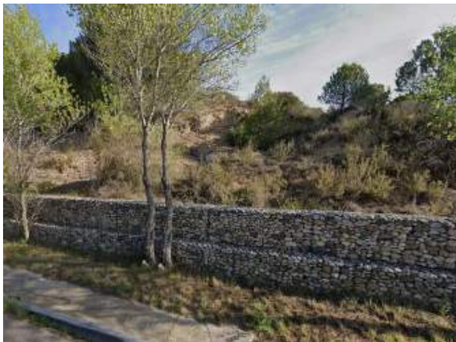
Fotografia 18: Vista del lliscament ocorregut probablement als anys noranta a conseqüència de modificar les condicions d'estabilitat prèvies a la realització del talús. En la imatge s'observa part del dipòsit i de la cicatriu. Aquest fenomen va obligar a construir l'escullera de gabions per tal de protegir la B-224.
